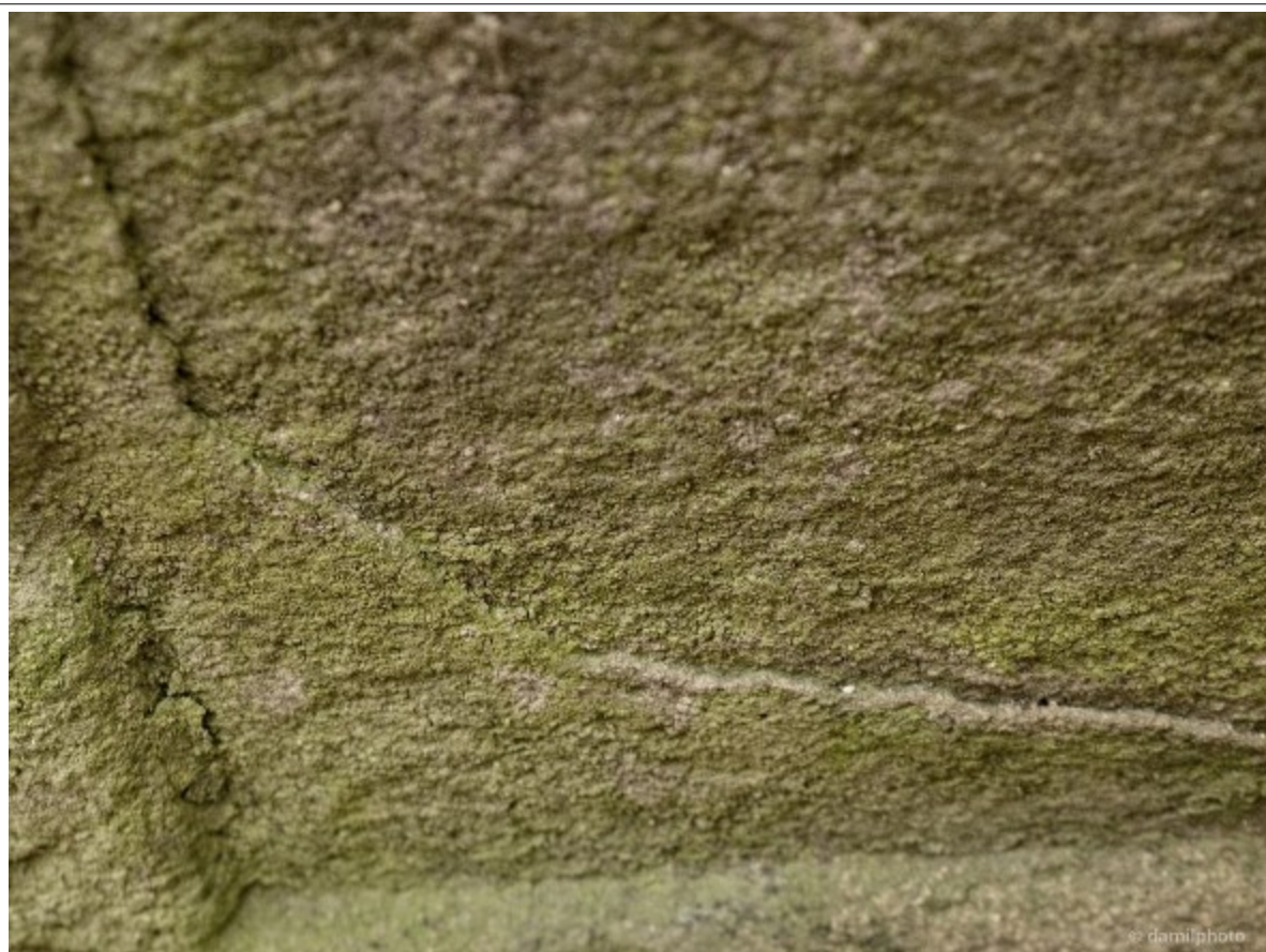
Detail poškození – odlupování vrstev vlivem vzlínání půdní vlhkosti
