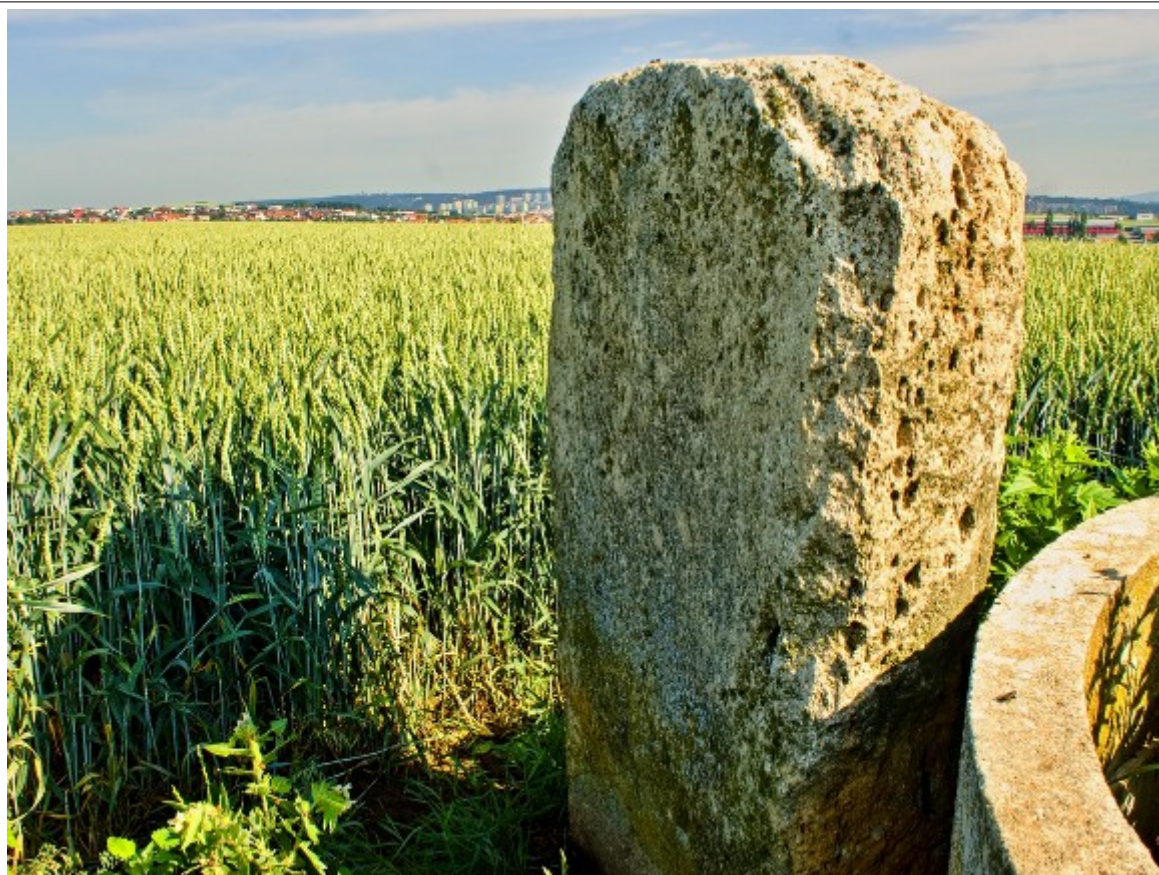
Eroze kamene je v některých místech alarmující
