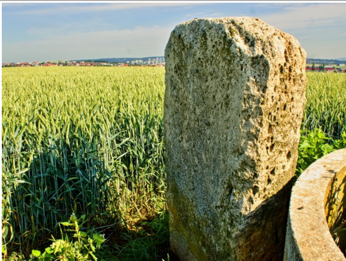
Eroze kamene je v některých místech alarmující
