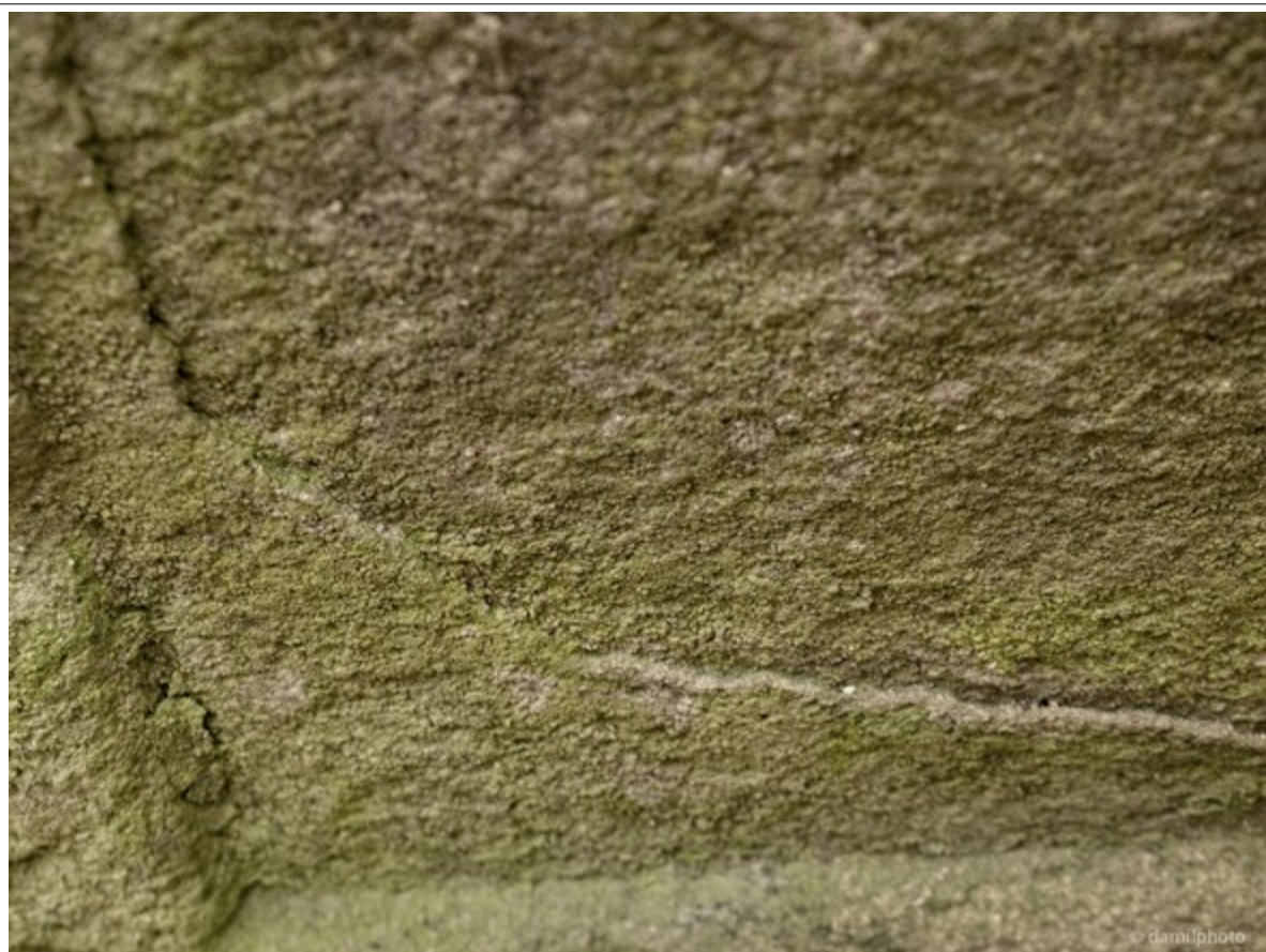
Detail poškození – odlupování vrstev vlivem vztlínání půdní vlhkosti
